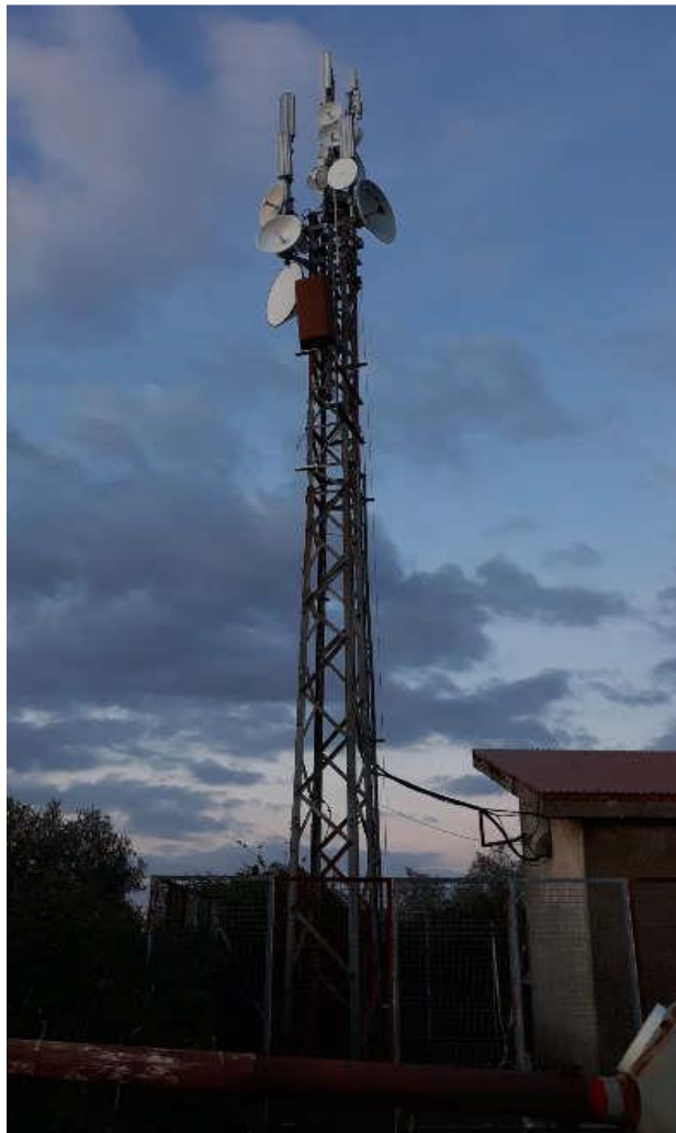
Equipamiento instalado en la torreta del antiguo Centro de Televisión
